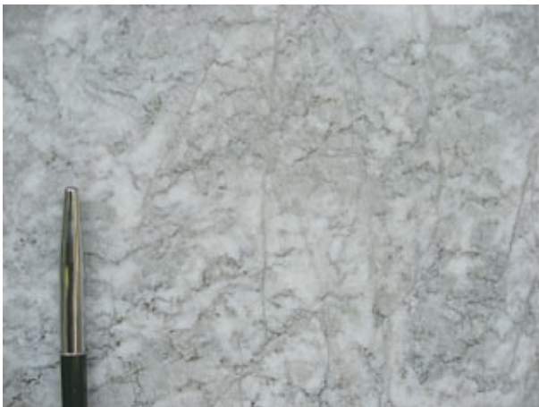
図16. 正面テラス外壁の大理石。風化しているが、パターンが図5および図12の国産大理石によく似ていることが分かる。
