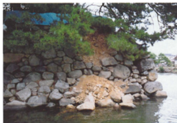
写真-1 鳥取県西部地震による二之丸下ノ段南東角堀石垣崩壊
