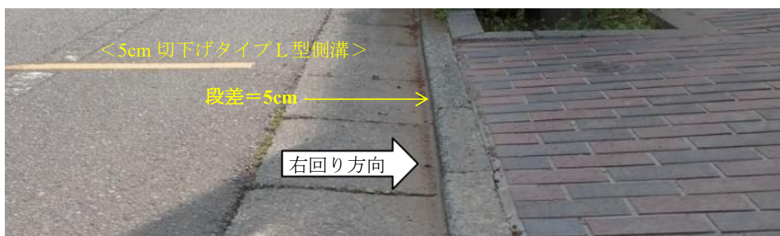
図-57 ⑧地点の段差（右回り方向）
