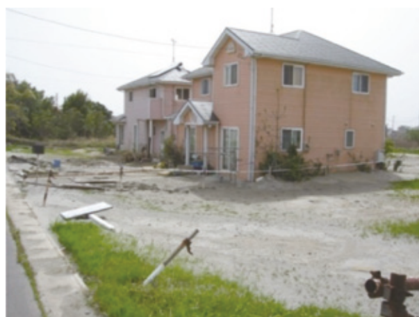
写真-1 茨城県神栖市の液状化による住宅地の沈下
