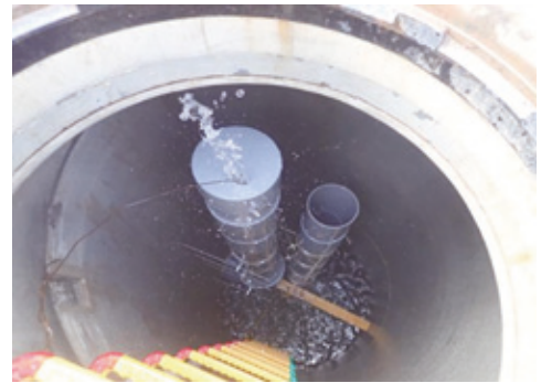
図-7 No.3人孔の立ち上げ管
