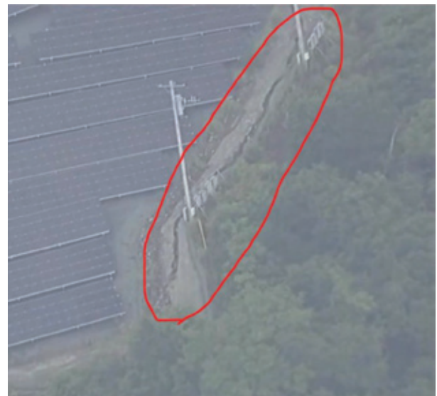
写真-19 ソーラーパネル施設管理用道路の亀裂 9)
