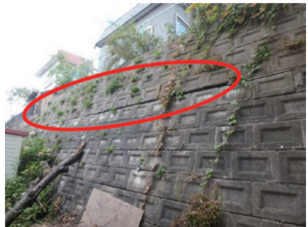
写真-3 練石積擁壁の変状
