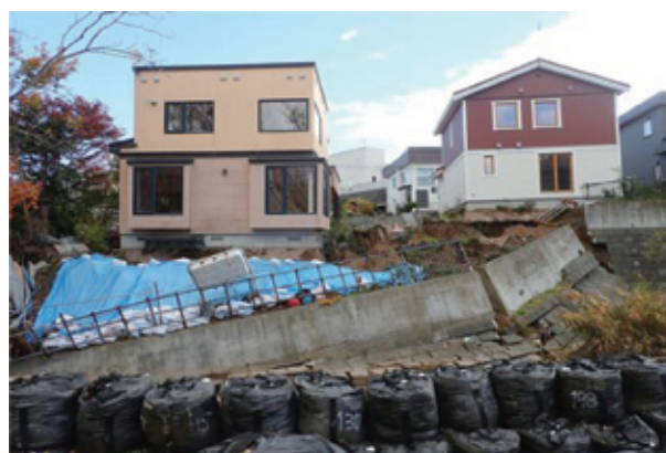
写真-1 北広島市大曲地区における盛土地盤の崩壊
