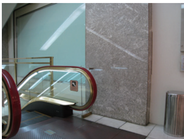
図5 エレベーター付近に使われている「淡雪」。おそらく徳島県産。戦前から徳島県で産した銘柄であるが、昭和40年代頃に山口県でも同様の色柄のものが産し「残雪」「新淡雪」等と呼ばれていたことが分かっているため、この箇所の改修年代次第では産地が異なる可能性もある。
