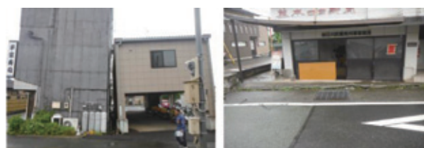
(a) 建物の傾斜 (b) 建物のめりこみ沈下
