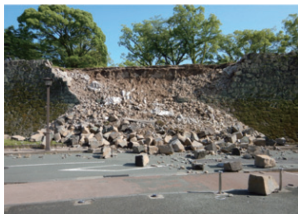
写真-1 百間石垣の崩壊
