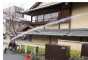
写真3 易操作性1号消火栓
