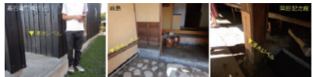
写真9 伝建地区の浸水状況
