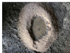
図6 空気漏れ箇所の処理
