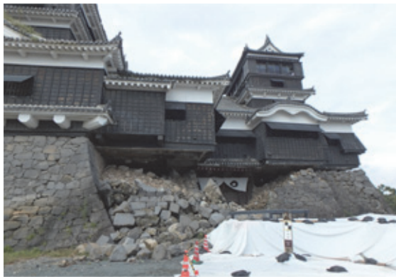
(a) 東側の石垣崩壊
