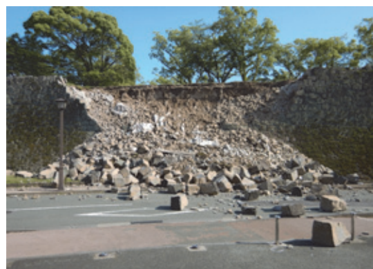
写真-1 百間石垣の崩壊
