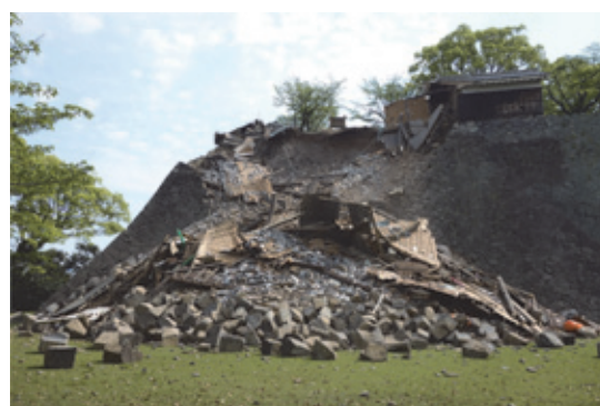
写真-2 重要文化財「北十八間櫓」の崩壊
