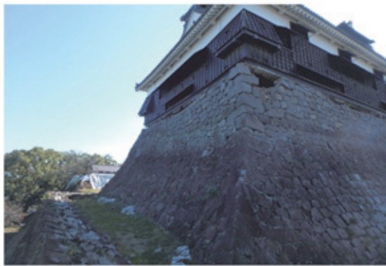
(b) 北西側の石垣崩壊
