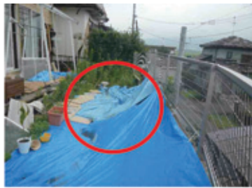
(b) (a) 宅地地盤の状況 (益城町)
