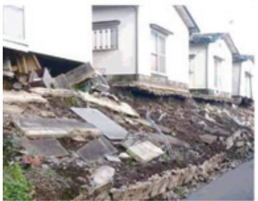
(g) 練石積擁壁の倒壊 (益城町)
