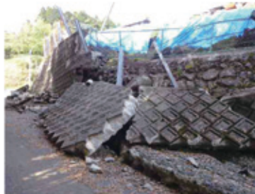
(e) 練石積擁壁の倒壊 (西原町)
