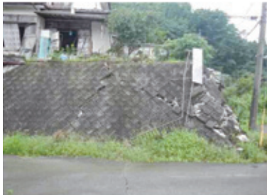
(d) 練石積擁壁のコーナー部の崩壊 (益城町)
