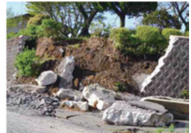
(f) 練石積擁壁の倒壊 (南阿蘇村)
