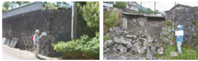
(a) 石積擁壁のクラック (b) 石積擁壁の崩壊調査
