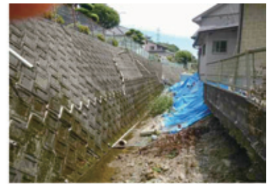
(c) 練石積擁壁の横クラック (益城町)
