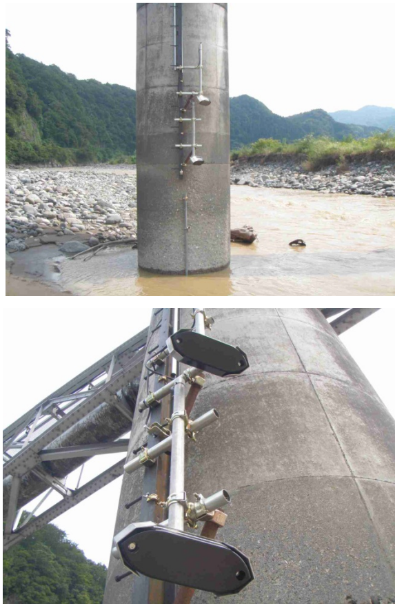
図 5-13 音響測深機による河床高自動モニタリングシステムの実例 (H川観測所地点、水管橋の橋脚に音響測深機を設置)
